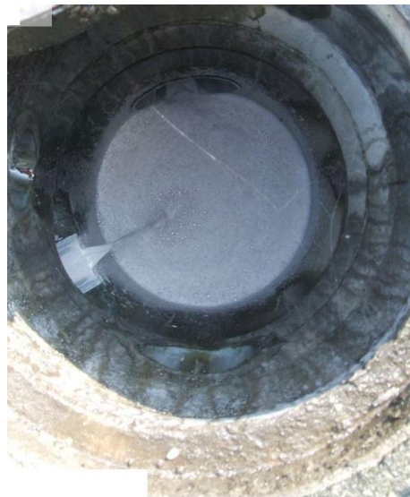
人孔の白濁の痕跡
